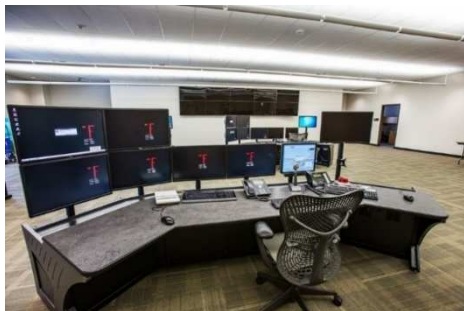
TRD 路線集中監視コントロール室
