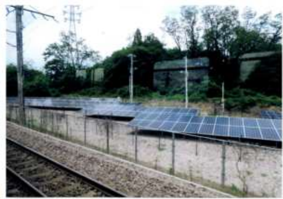
鉄道線路沿いに設置の太陽光パネル
