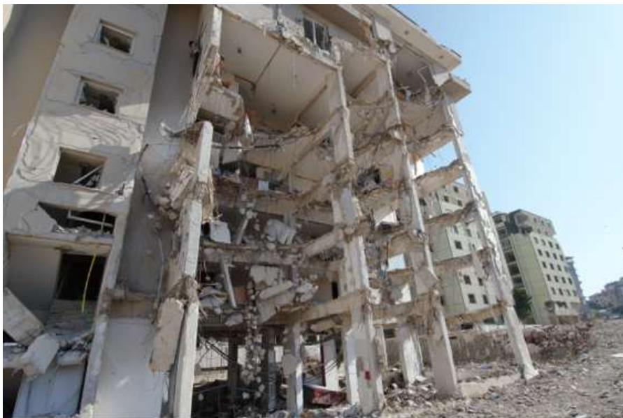
（PH①）約 3100 棟が崩壊し、2 万人以上の死者を出したアンタッキヤのマンション
