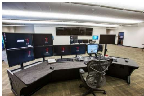
TRD 路線集中監視コントロール室
